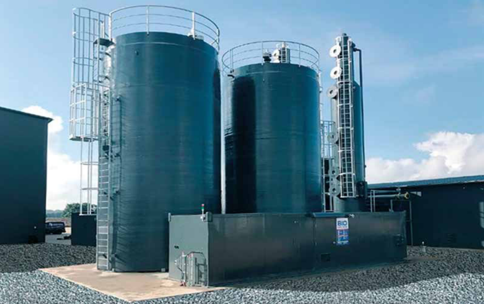
ILLUSTRATION 5.4 Installation de désulfuration Biogascleaner QSR au sein de Nature Energy Maansson à Brande, au Danemark. PHOTO Biogasclean.
