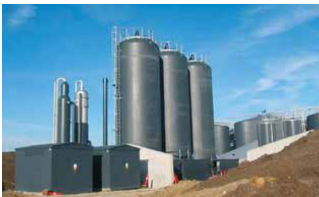
ILLUSTRATION 5.5 Installation de désulfuration Biogascleaner QSR à NGF Nature Energy Kors kro au Danemark. PHOTO Biogasclean.
